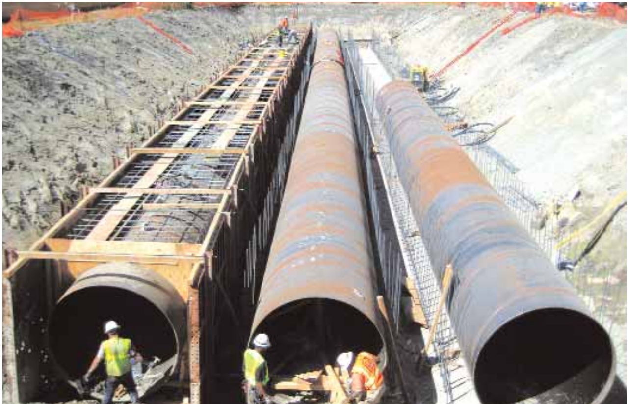
Future Hetch Hetchy conduits.
